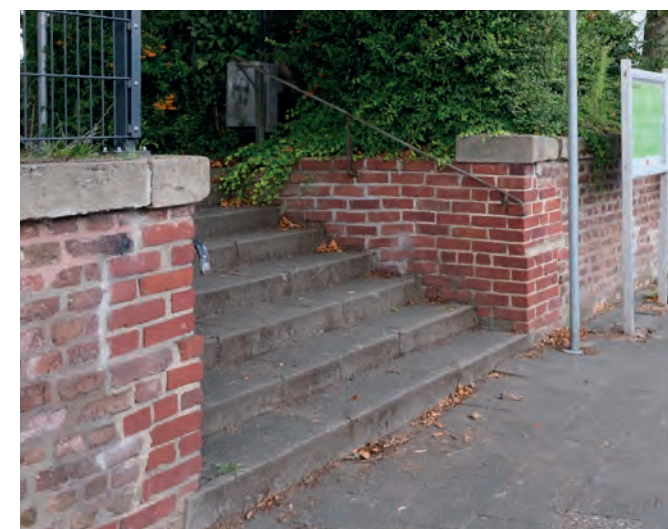
Abbildung 66: Marode Mauer mit Sanierungsbedarf
